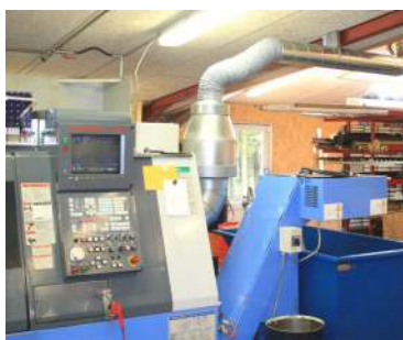
Udsugning fra bearbejdningsmaskiner
