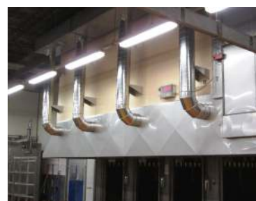
Emhætte med udsugning fra rygeovne
