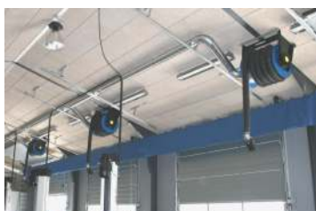
Rumventilation og røggasudsugning
