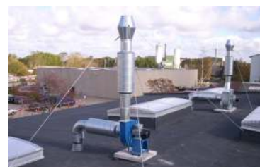
Udsugningsventilatorer på tag
