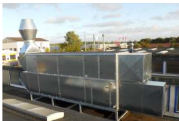
Ventilationsaggregat med 2 krydsvekslere til varmegenvinding med luftmængde på 13.500 m 3 pr. time
