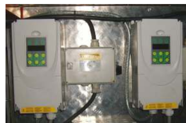
Frekvensomformere regulerer luften i Davenkas energioptimering. Dermed bruges kun den energi, der er behov for
