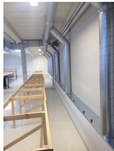
Ventilation til limningskabine
