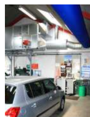
Rumventilation i autoværksted
