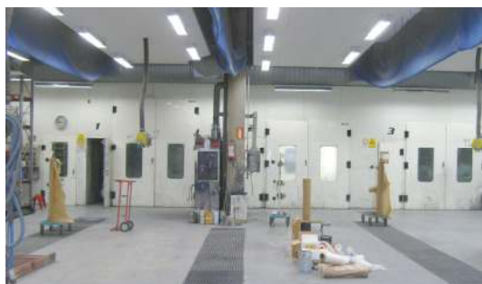
3 sprøjte-/tørrekabiner hos City Autolakering er opgraderet med Davenka Energisparepakke
