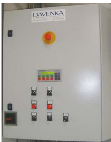
Styretavle til Davenka Energisparepakke
